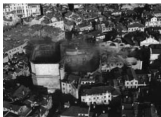
1 Situazione ad incendio spento, con il crollo di tutte le coperture e soffitti
