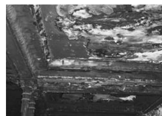
15 Parziale carbonizzazione superficiale delle decorazioni del Foyer
