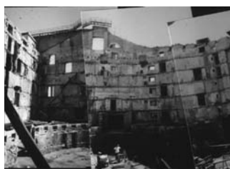
3 Il castello dei palchi completamente bruciato; restano le pareti perimetrali un tempo esterne ai corridoi
