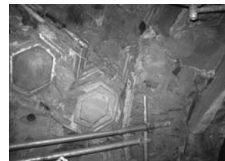
22 Situazione di grave degrado del paramento lapideo interno con fatturazioni, rigonfiamenti, distacchi, alterazioni cromatiche e parziale messa in luce delle strutture murarie retrostanti
