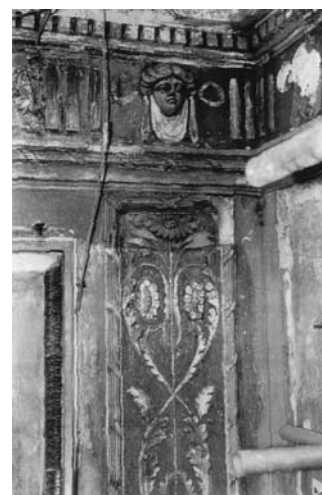
4 Lacerti di intonaco a marmorino e di stucchi forti presenti al piano delle Sale Apollinee e sopravvissuti all'incendio
